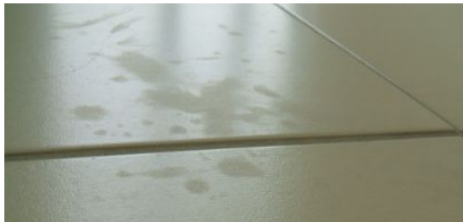
Imagem 103: Dano químico causado pelo gotejamento de produto não recomendado.
