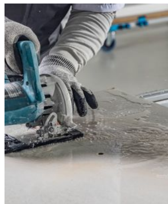
Imagen 87: Finalice la apertura del corte hasta el círculo utilizando la sierra de porcelanato.
