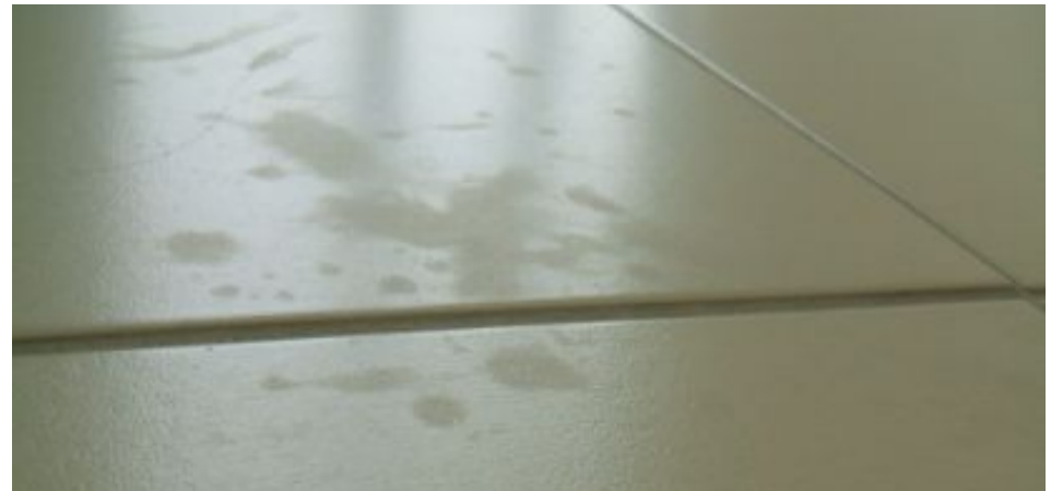
Imagen 103: Daño químico causado por el goteo de un producto no recomendado.
