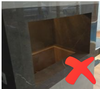
Imagen 10: No se recomienda asentar el revestimiento en la parte interna del asador de porcelanato; debe ser ladrillo refractario.
