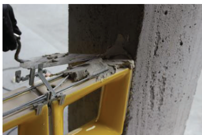
Foto 18: Inserção da treliça plana nas juntas de assentamento
