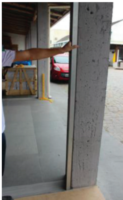
Foto 06: Conferência de irregularidades na parede
