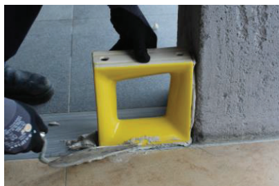
Foto 12: Remoção dos excessos de argamassa colante e preenchimento total da junta – opção de assentar e rejuntar simultaneamente
