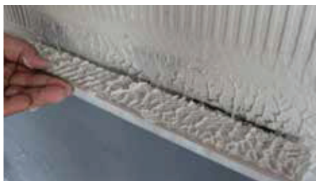
Foto 19: Cordões de argamassa colante completamente esmagados
