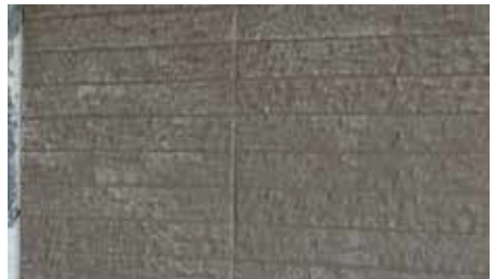
Foto 29: Juntas preenchidas com rejunte e excesso na superfície das placas
