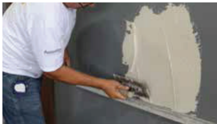
Foto 15: Aplicação da argamassa colante na base de assentamento com lado liso da desempenadeira
