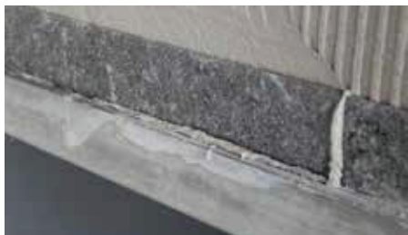
Foto 21: Excesso de argamassa colante nas juntas entre as pastilhas
